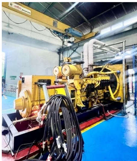
Gambar 2.1 Genset Komatsu PLTD Kairatu (Sumber: PLTD Kairatu)
