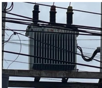
Gambar 2. Trafo Distribusi 100 kVA
