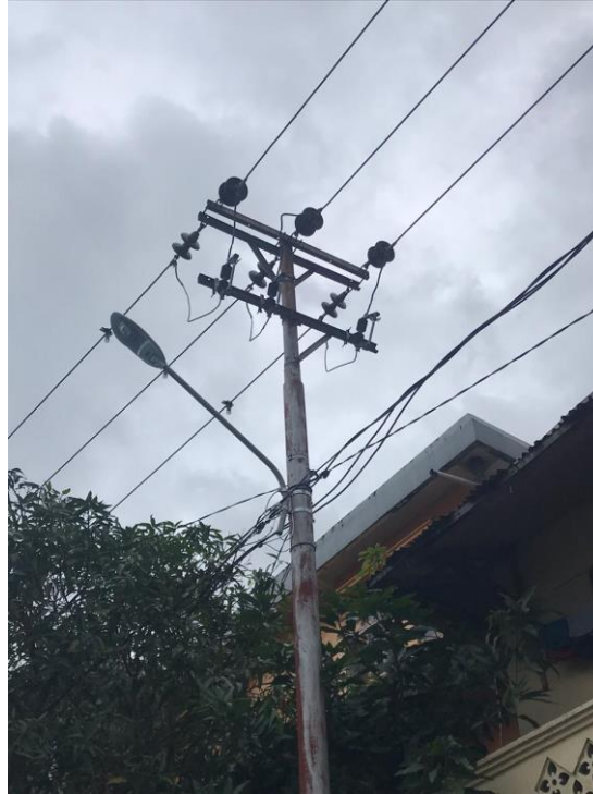
Gambar 1. Fuse cut out (FCO) pada percabangan
